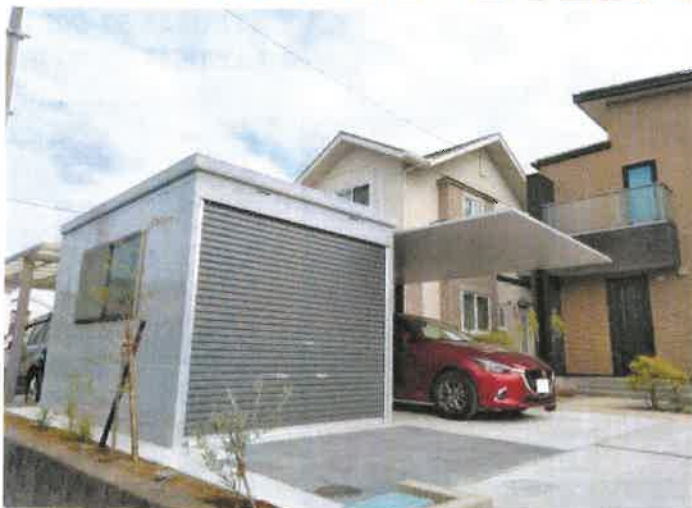
▲カーポートとバイク保管庫の設置工事 【市内W様邸】 元請:ユニプレスサービス(株)
